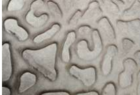
Déformation du matériau
